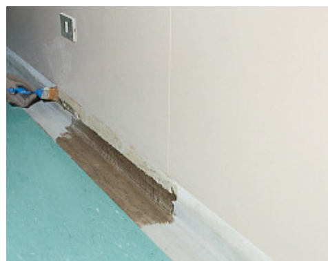
Application d'une plinthe de finition en PVC liuni avec Adesilex LP - Istituto Tumori - Milan
